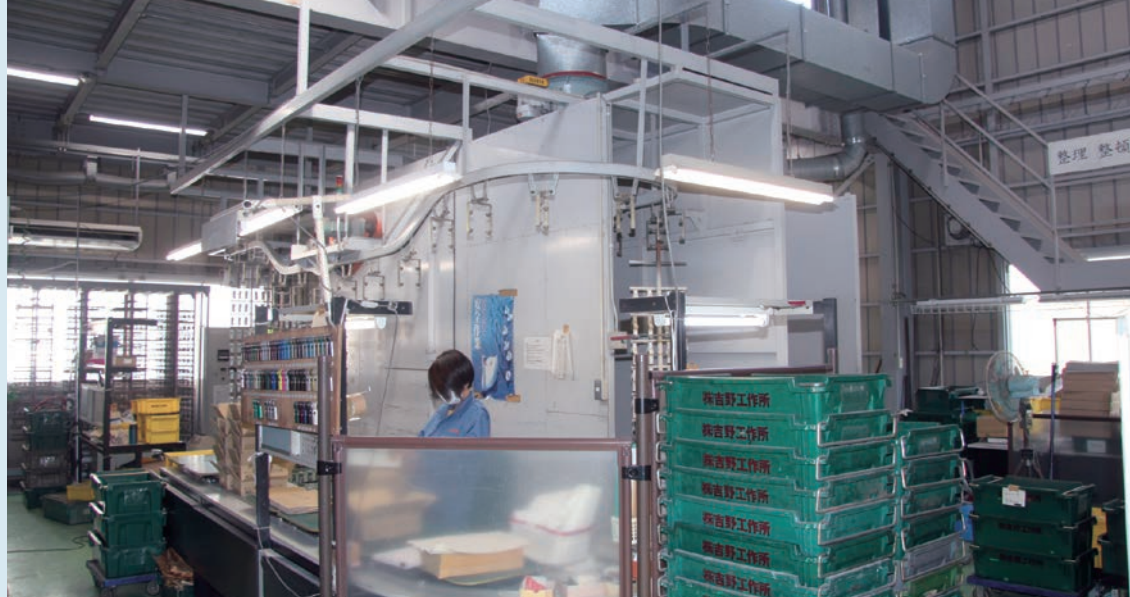
▲ 塗装ブース全景(コンベヤー側)
