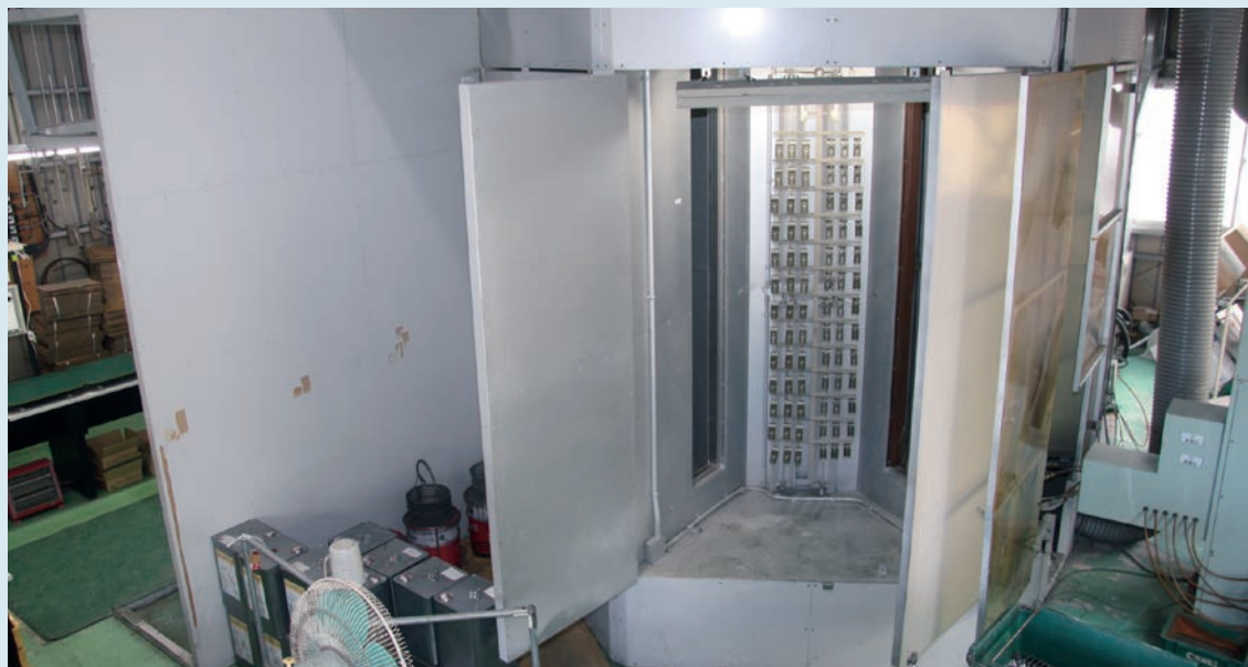
▲ 塗装ブース全景(塗装・乾燥ブース側)
