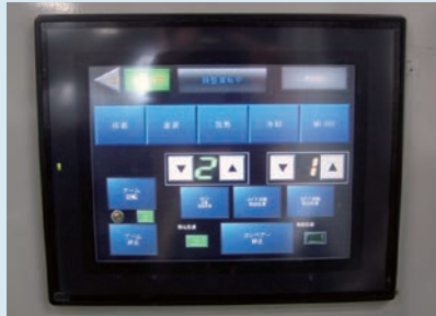
▲塗装制御盤と操作パネル
